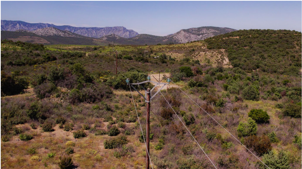
Installation de 120 équipements de protection pour les rapaces sur des poteaux électriques (©Valeco)
